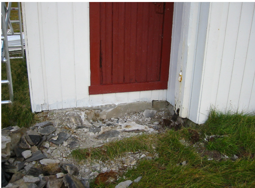
Bilde 24: Baktrapp før utbedring (Foto: G. B.).
