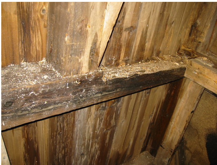
Bilde 2: Råteskade i hovedsvill, tårn (Foto: G. B.).
