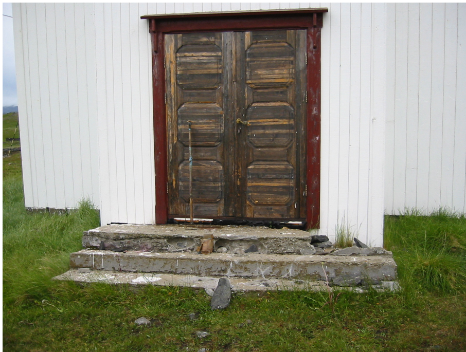
Bilde 17: Hoveddør før utbedring (Foto: G. B.).
