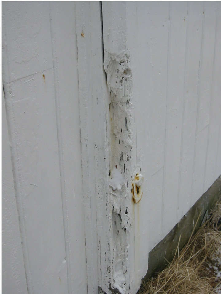
Bilde 14: Råteskade i gammel hovedstav (Foto: G. B.).
