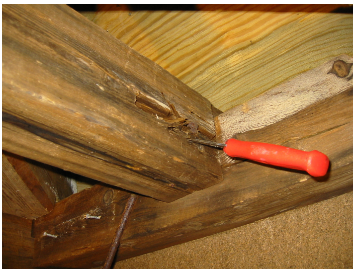
Bilde 1: Råteskade i konstruksjon (Foto: G. B.).
