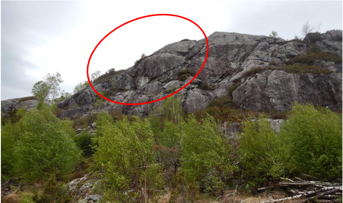
Foto 7 Bergskrenten helt vest i IL1. Eksempel på område som bør boltes
