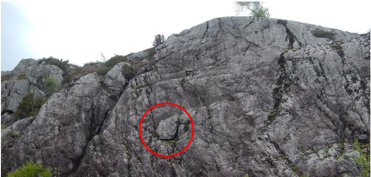
Foto 8 Bergskrenten helt vest i IL1. Eksempel på blokk som bør renskes ned
