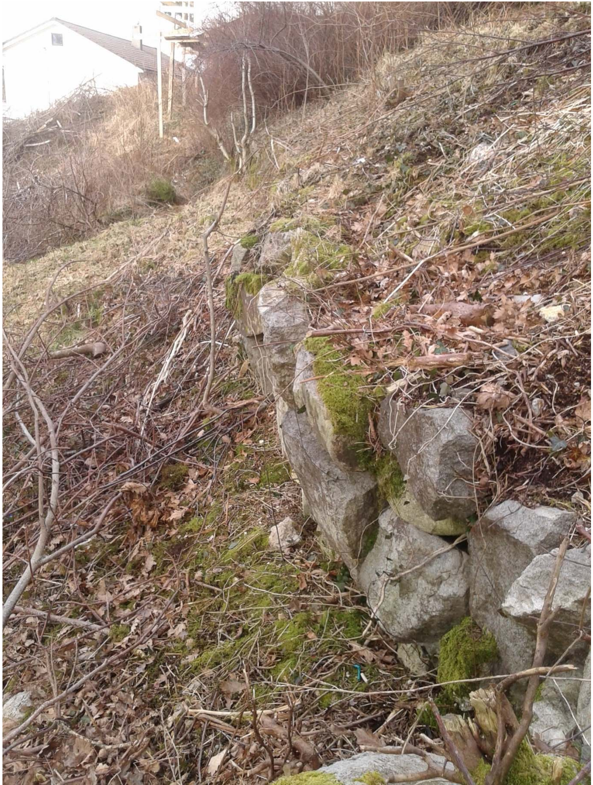
Foto 15 Natursteinsmur som «buler» ut er registrert i toppen av skråningen.
