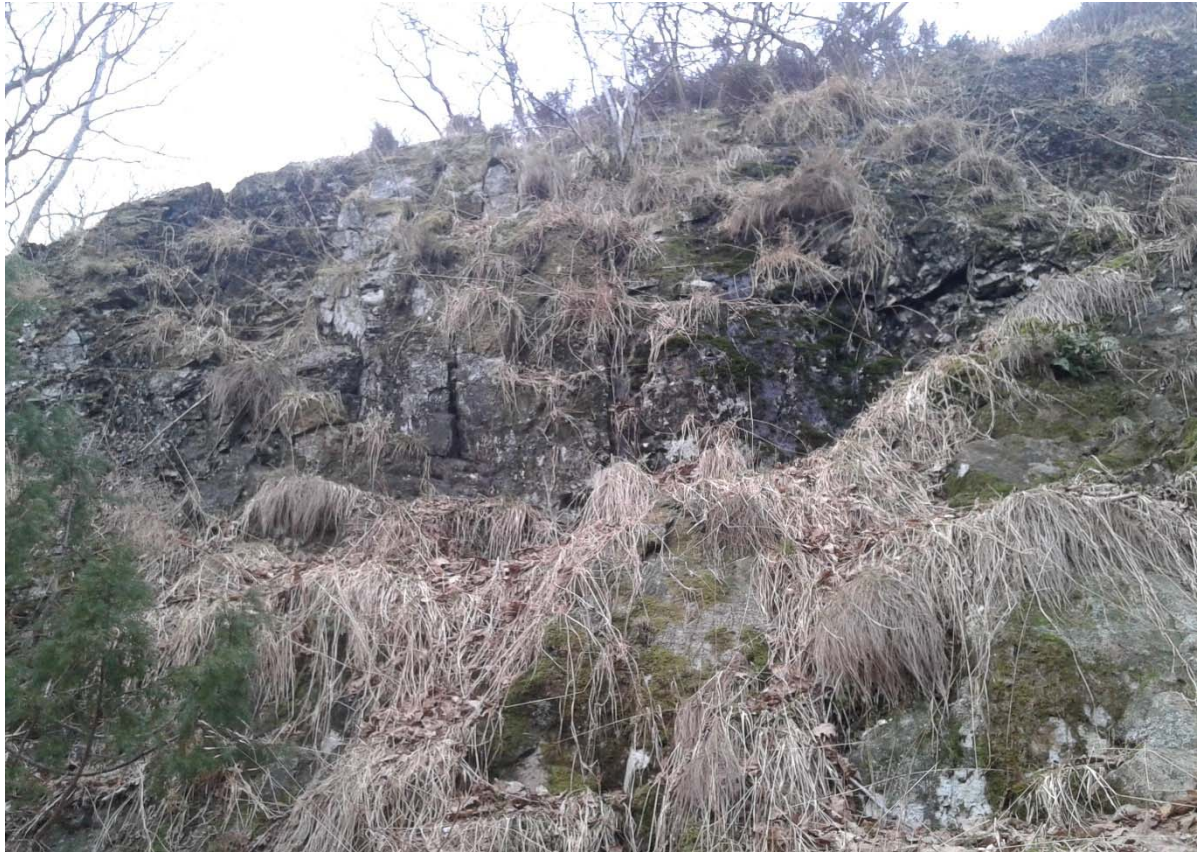
Foto 13 Lokalitet 10. Aktuelle sikringstiltak er rensk, bolter og steinsprangnett.
