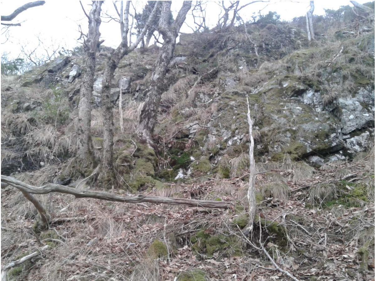
Foto 11 Lokalitet 8. Aktuelle sikringstiltak er rensk, bolter og steinsprangnett.
