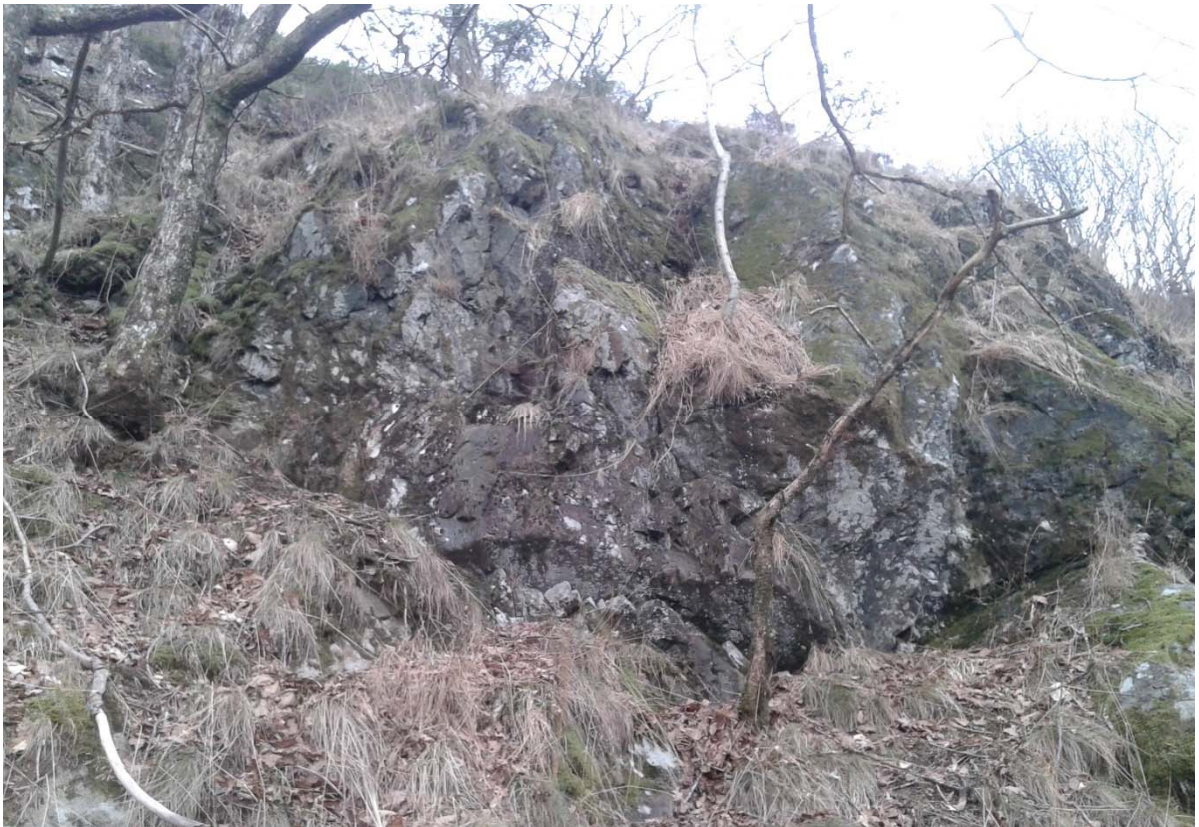
Foto 12 Lokalitet 9. Aktuelle sikringstiltak er rensk, bolter og steinsprangnett.
