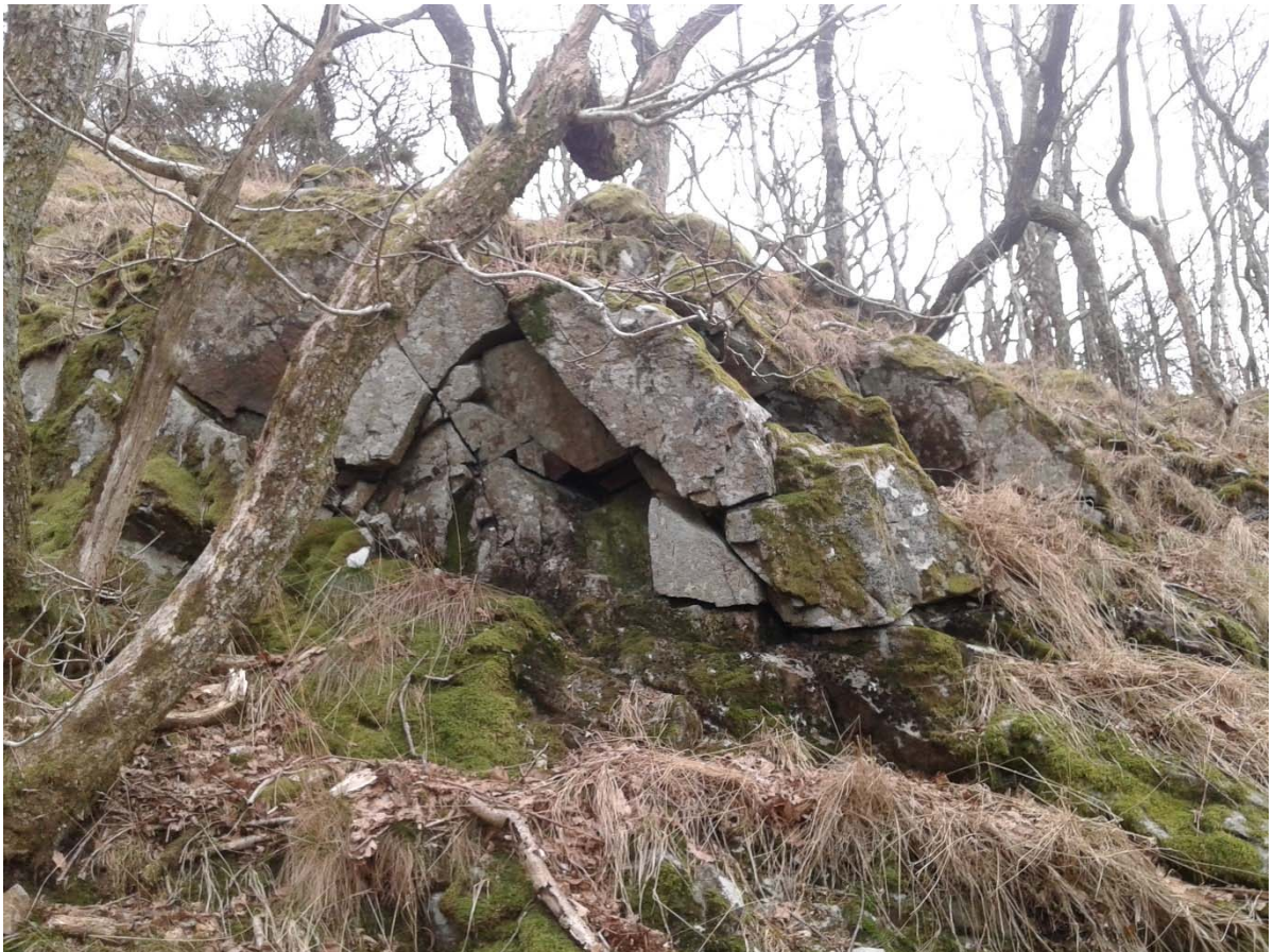
Foto 9 Lokalitet 6. Aktuelt sikringstiltak er rensk eller bolt/steinsprangnett.
