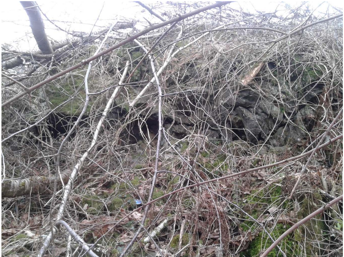
Foto 6 Lokalitet 3. Vegetasjonen må renskes, og aktuelle sikringstiltak er steinsprangnett og bolter.
