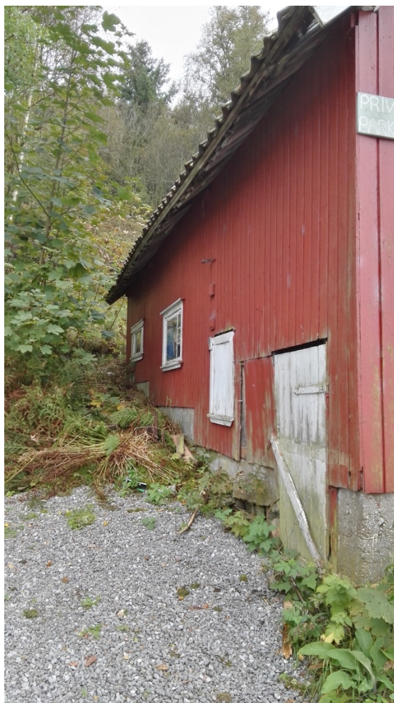
Kledning på østside må skifte.
