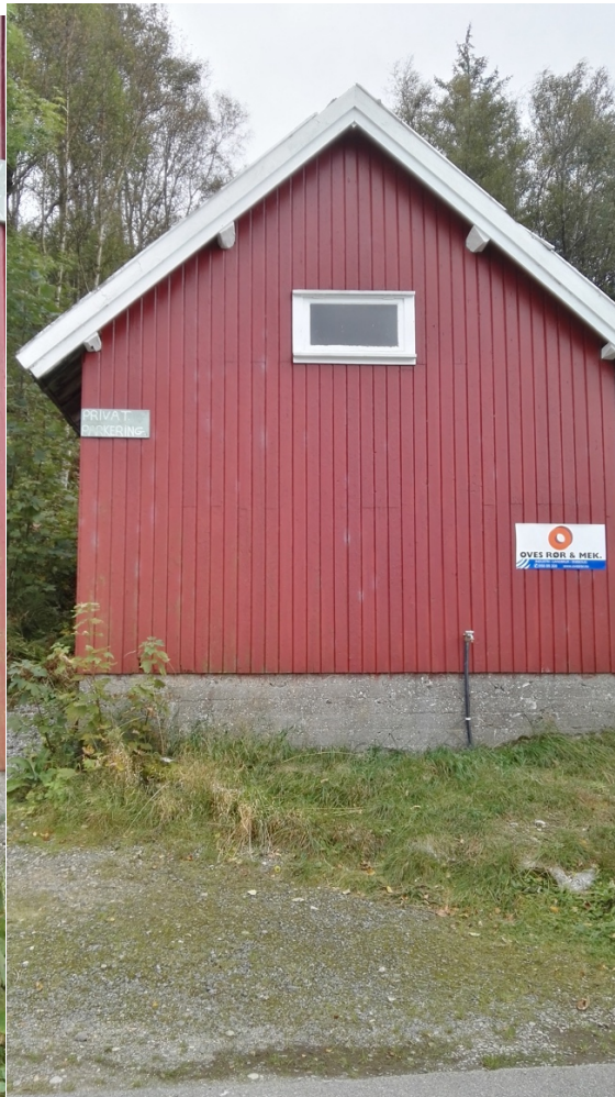
God kledning på nordsiden. (uoriginalt vindu)
