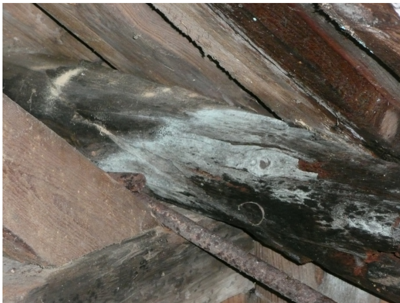
Takåsene er råtnet
