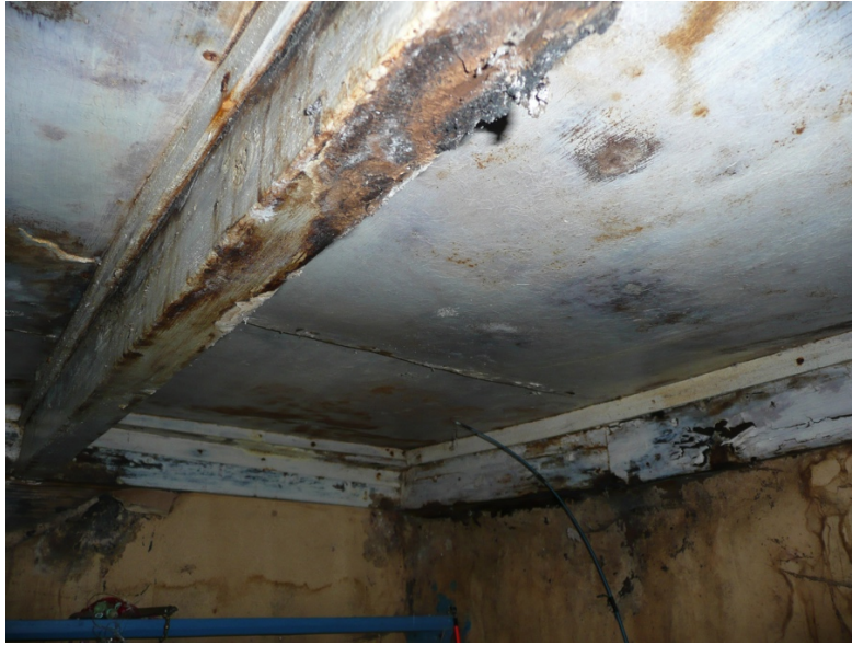
Tak i rom i løa. Betydelige råteskader.
