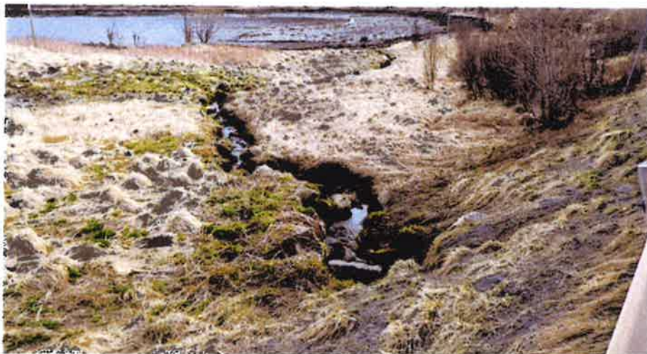
Figur 2-2 Terreng på sjøsiden av krysset fv. 820 x fv. 7656, med mye overvann.
