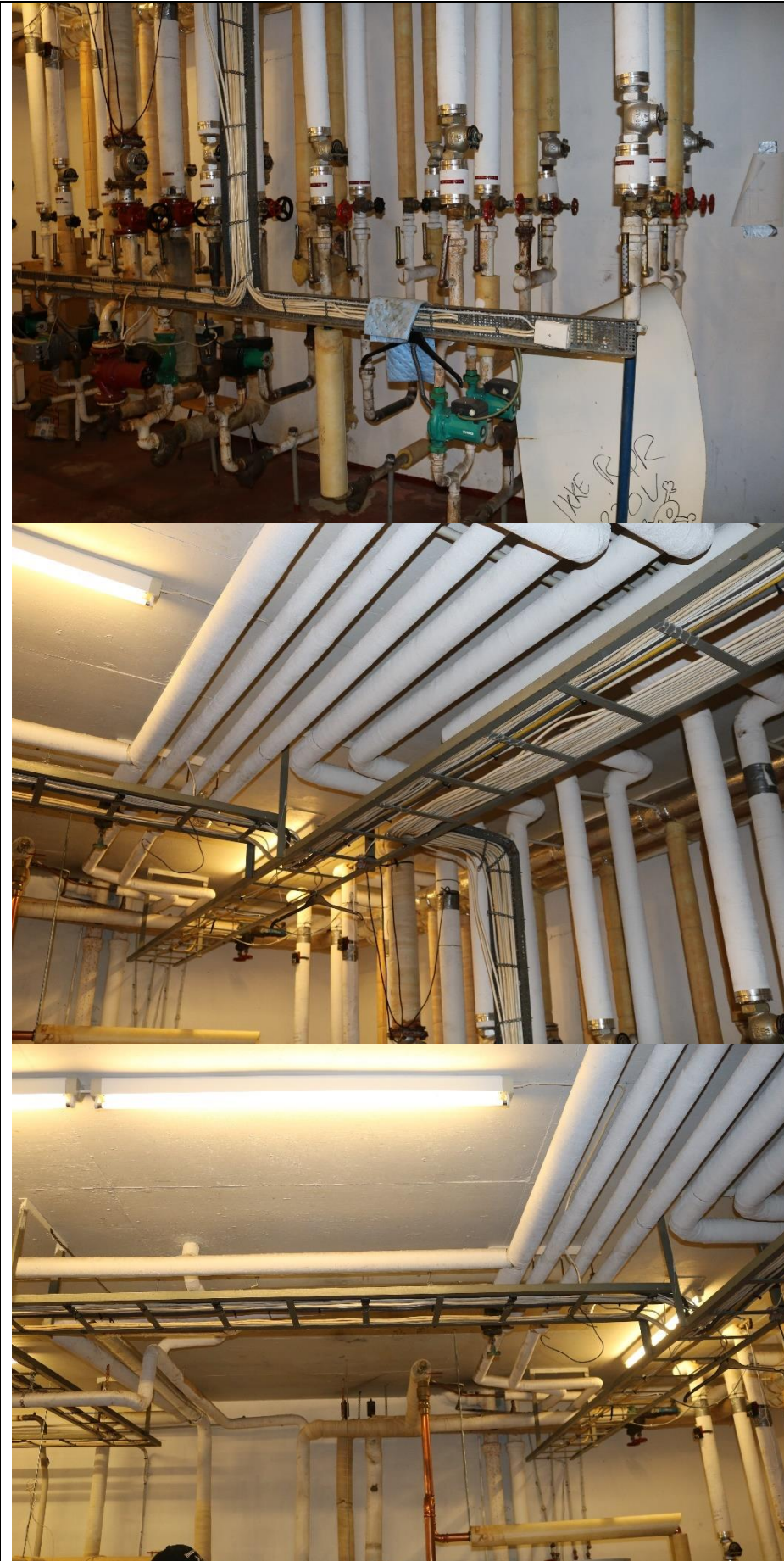
Teknisk rom for VA i kjeller.
