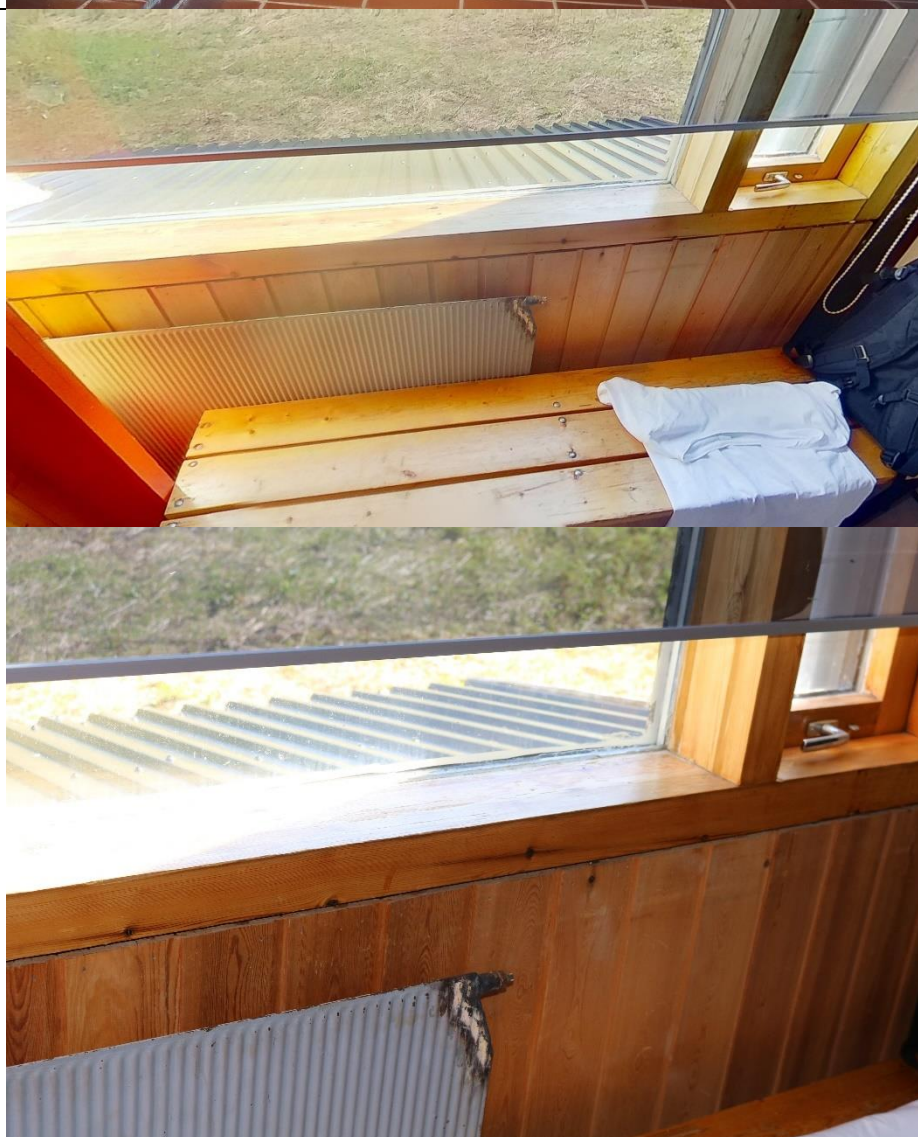
Bemerkes at radiatorer flere steder ser ut som de er brent på hjørnet i toppen der tempertatur- justeringen forgår.
