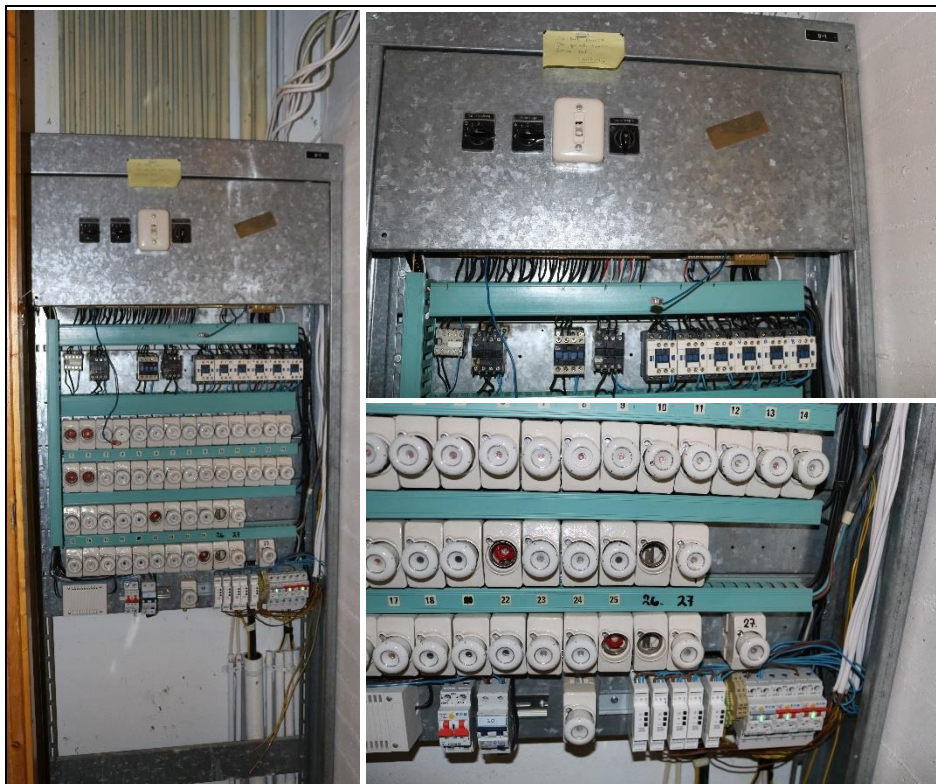
Eltavle i 1. etg. på bøttekott ved adkomsthall.
