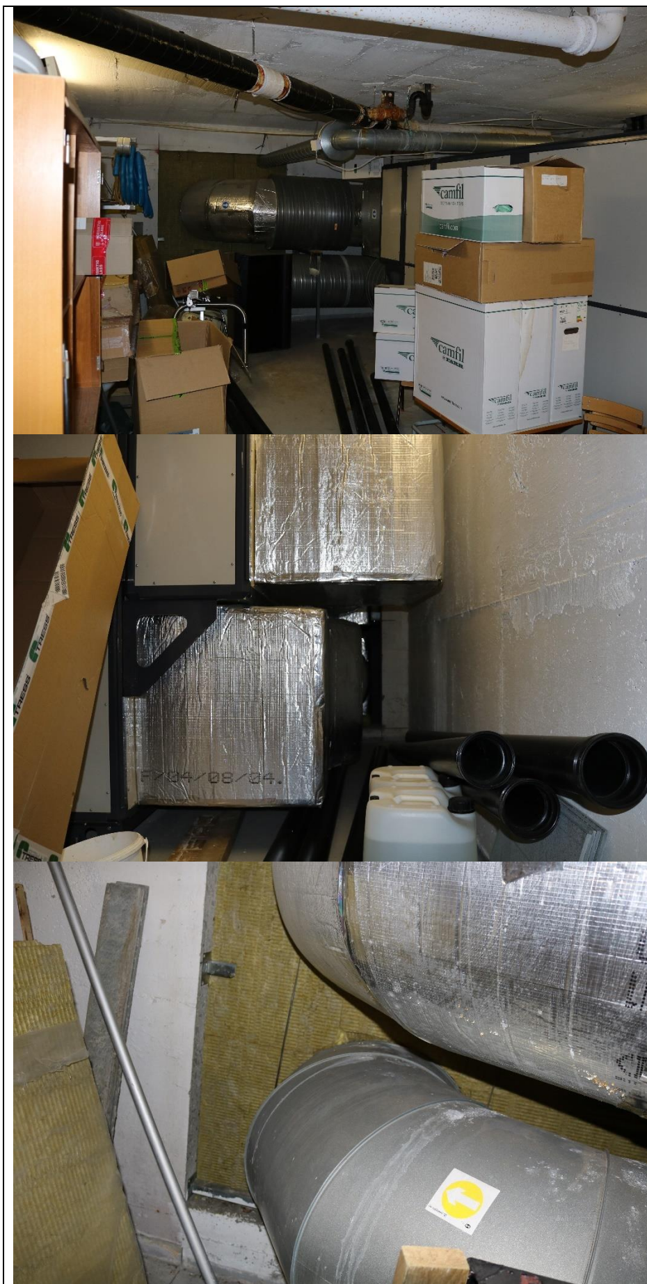
Teknisk rom for ventilasjon i kjeller
