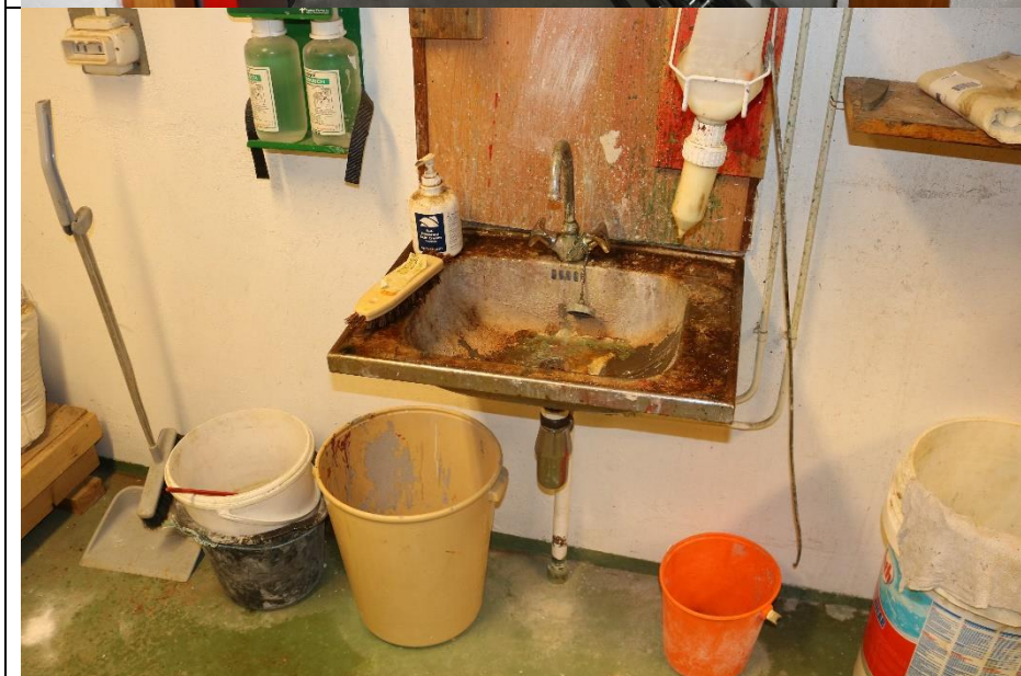
Utslagsvask i kjeller er meget skittent. Rommet generelt mangler renhold.
