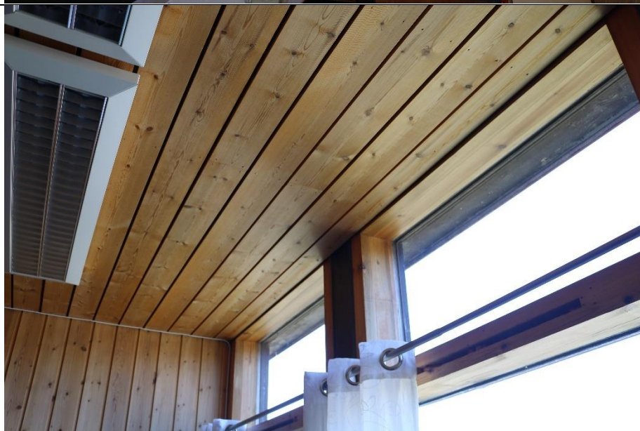
SFO, vestfløy; De store vindusfeltene er spesiallaget med karmen med full veggbredde slik at foringen innvendig også er karm. Pakning/tetting rundt glasset ser slitt og utett ut mange steder.
