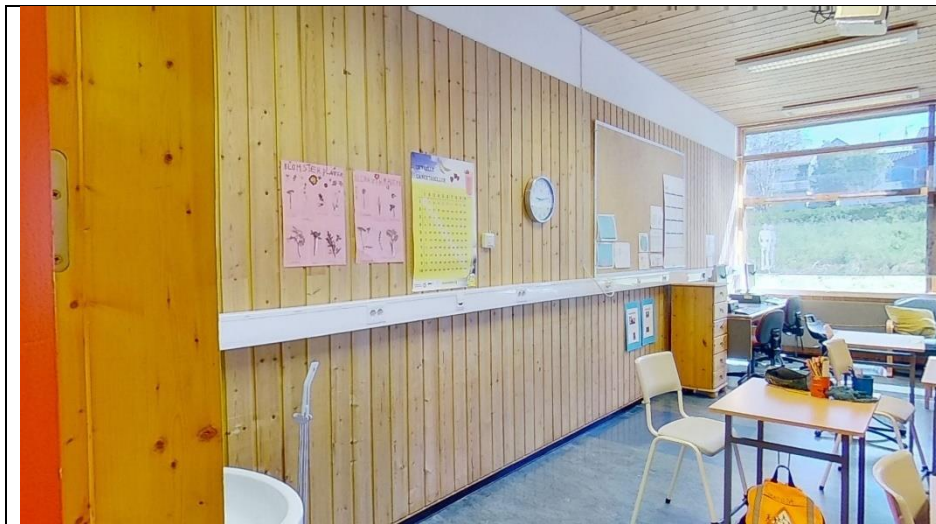
El-kanaler ettermontert på vegg går igjen flere steder. Generelt er det for få stikkontakter og el- kurser, også bemerket i pkt. 410.
