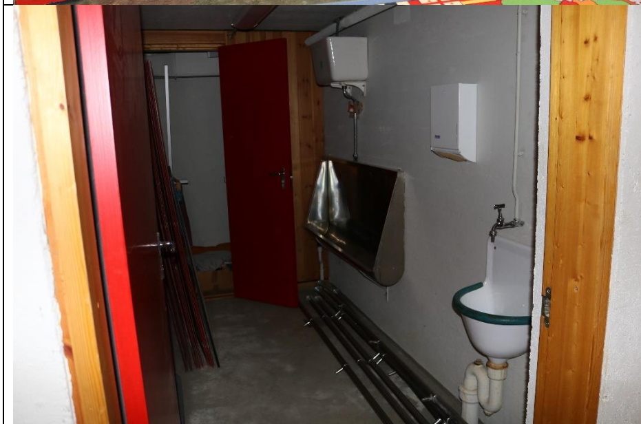
Urinal og utslagsvask i kjeller. Brukes mer som lager enn toalett per dags dato.
