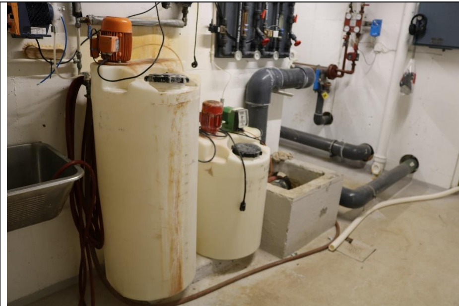
Teknisk rom i kjeller.
