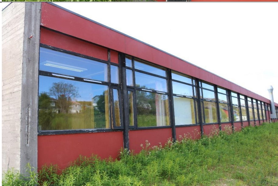
Slitte overflater på fasade.
