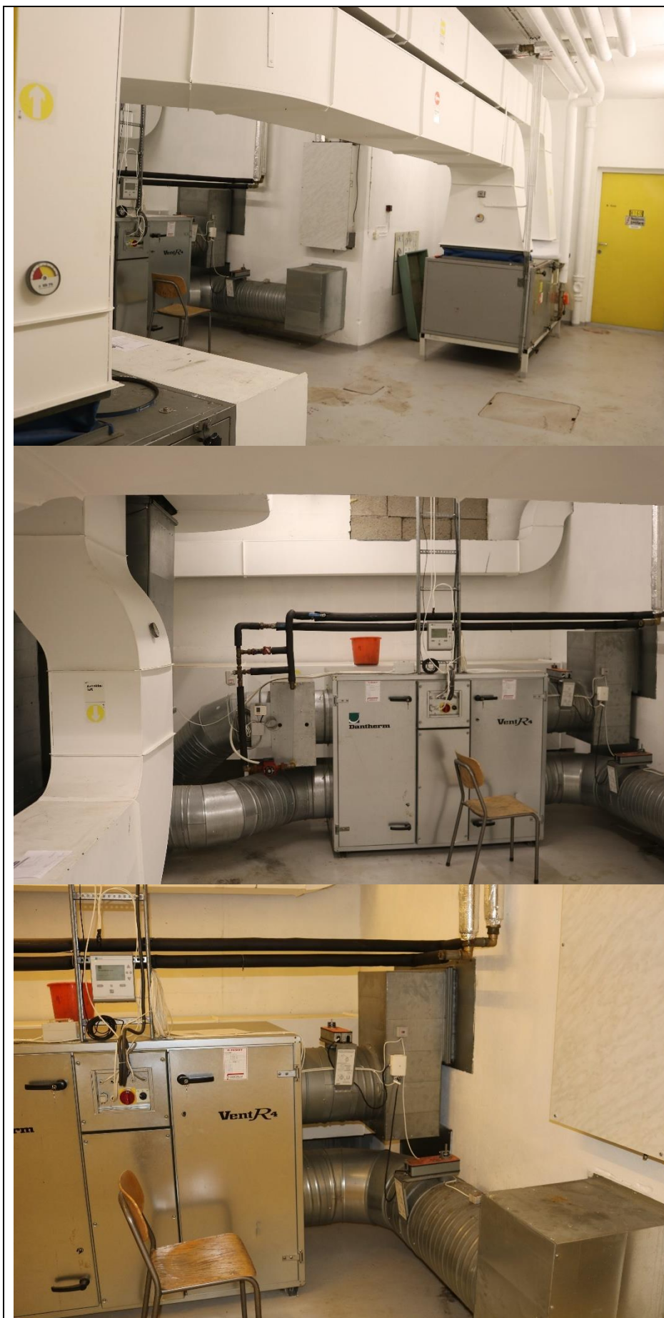
Teknisk rom for ventilasjons- aggregater i kjeller.
