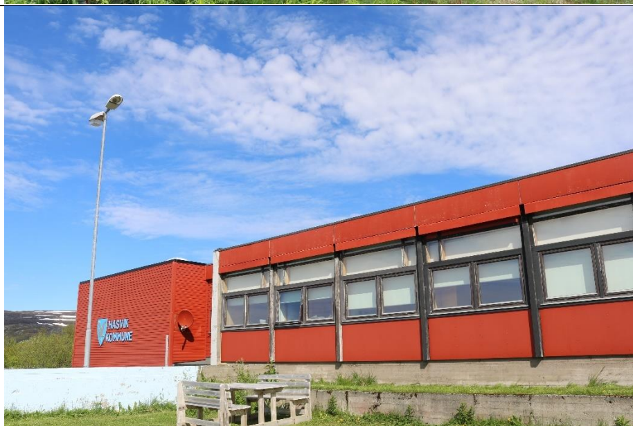
Slitte overflater på fasade.
