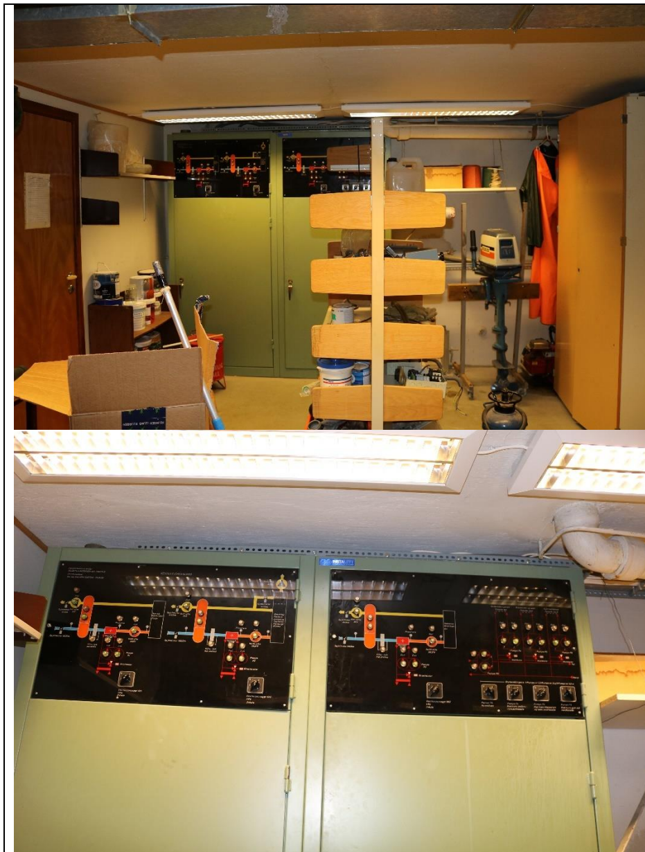
Styring for ventilasjonsanlegg av eldre type, antas fra 1977.
