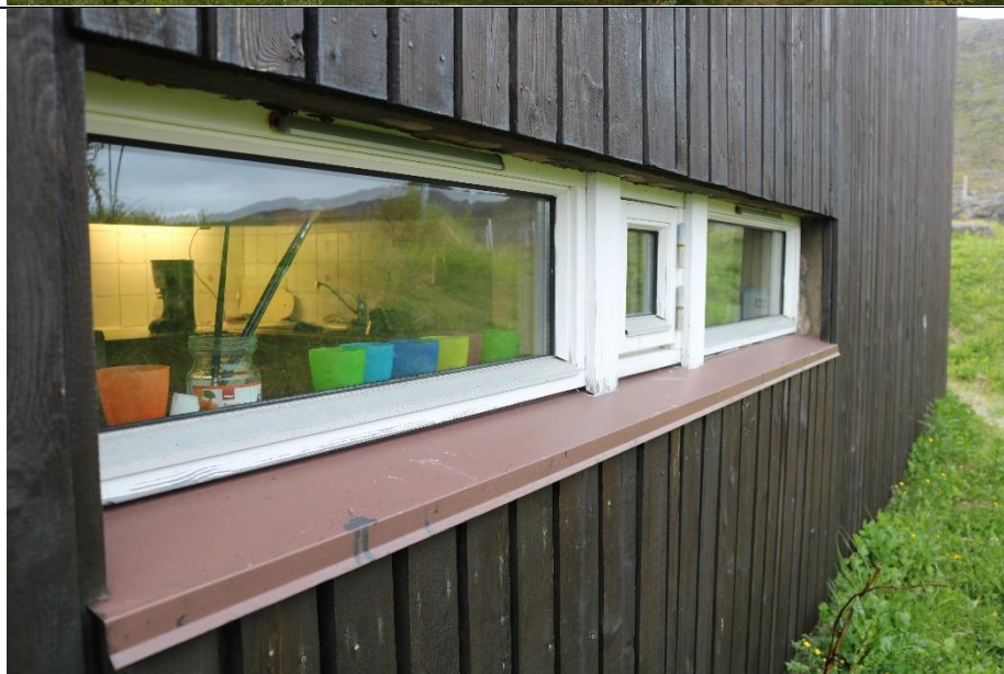
Vinduer i ok stand, men vegg bygget av Lecastein er ikke pusset bak panel, kun synlige deler. Lekker kald trekk på vinter og når vind står på veggen. Utvendig vindusforing kan se ut som betongpuss direkte mot vinduskarm.
