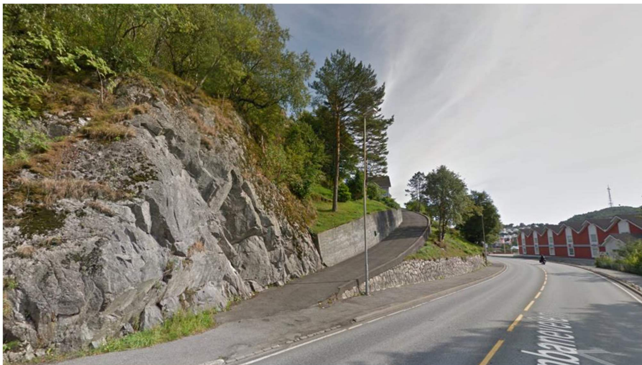
Figur 4-5: Planområdet sett fra Jernbaneveien, med vei opp til Jernbaneveien 19. Kilde: Google Maps.
